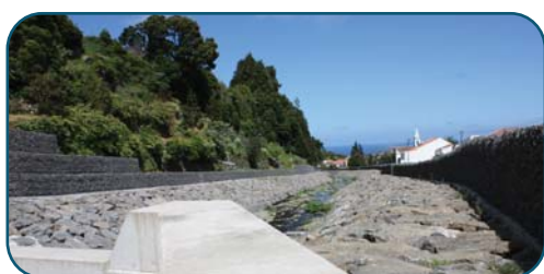
Intervenção Ribeira da Aqualva Reperfilamento Leito da Ribeira, Terceira Custo Total Elegível 1.524.225,46€ Apoio comunitário 1.295.591,64€
